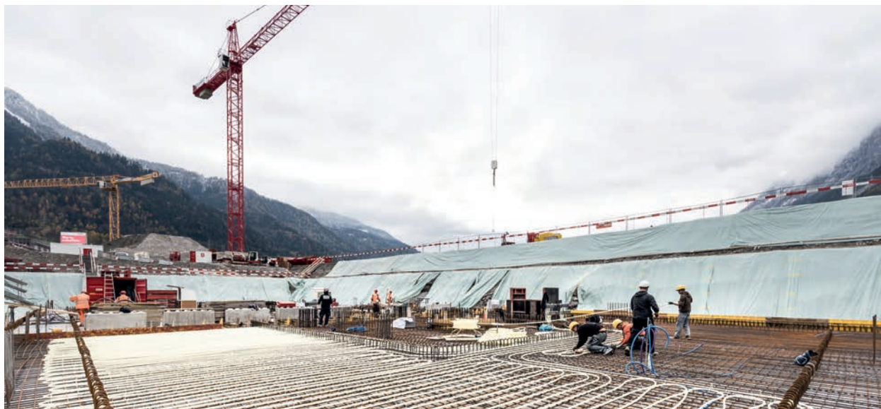
Der 1350 m 2 grosse Fundamentabsorber dient zur Wärme- und Kältegewinnung für eine Wärmepumpe. (Bild: Ingo Rasp)
