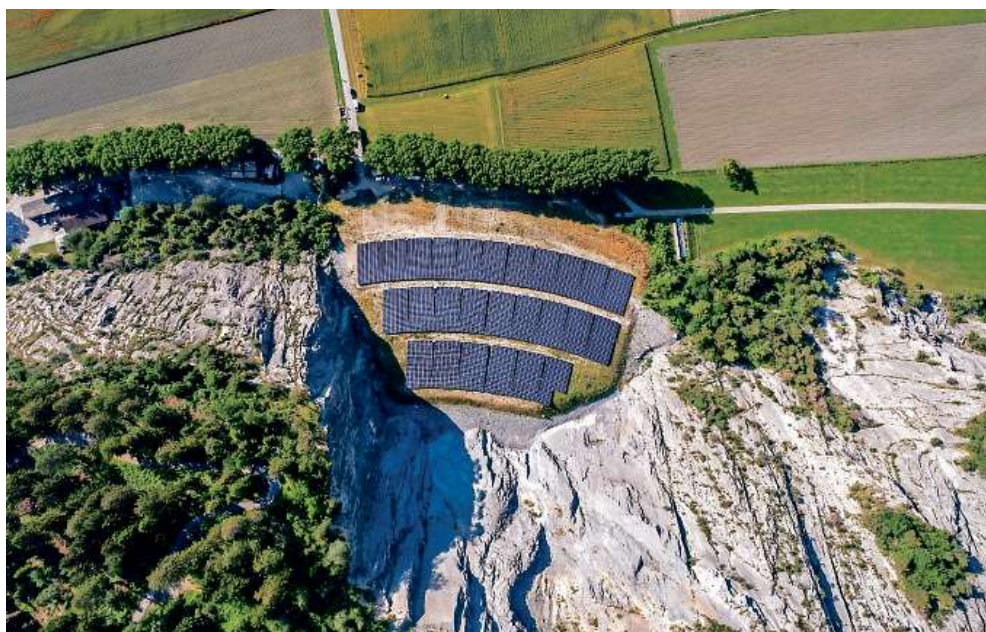
In Felsberg ist die grösste Solaranlage im Kanton entstanden. Pressebild
