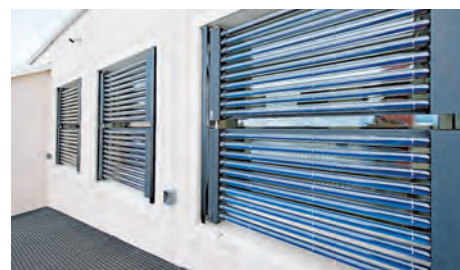
Röhrenkollektoren an den Fensterfronten.
