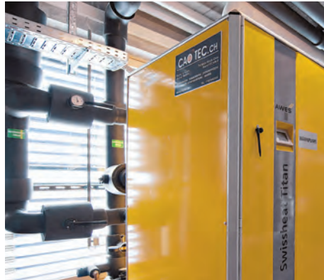
Die Haustechnikzentrale mit Wärmepumpe.
