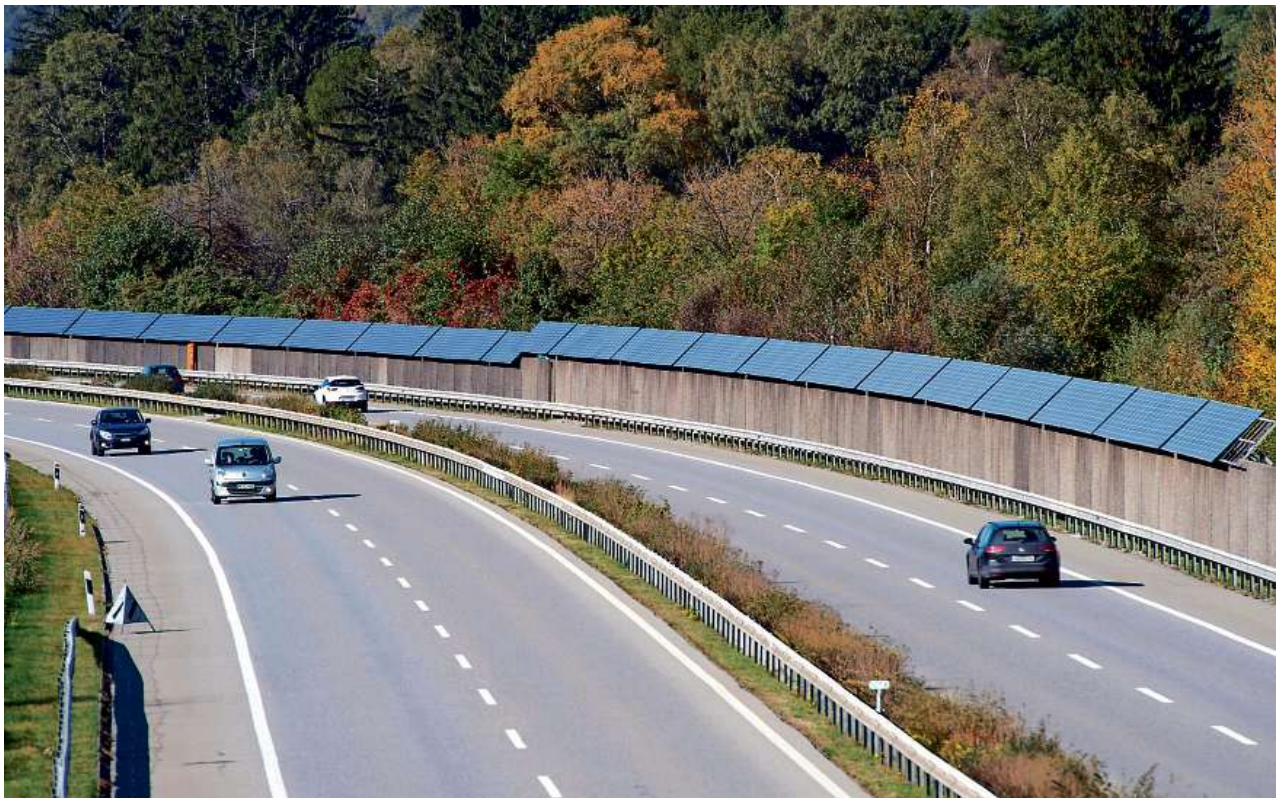
Produktion am Rand: Die revidierte Solaranlage an der A13 produziert mehr Strom denn je.
