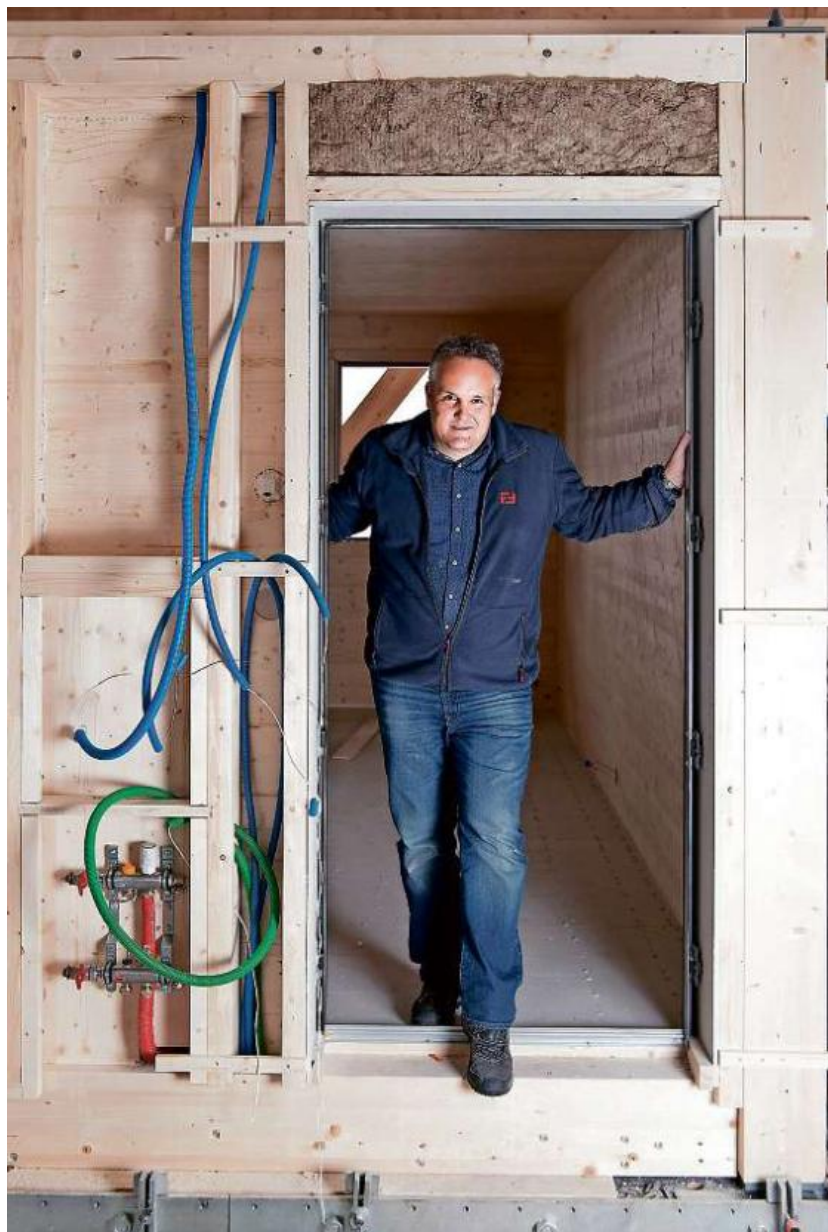
«Olympiazimmer» für die Kantonsschule: Momentan baut Enrico Uffer mit seiner Firma 102 Zimmer für das Konviktprovisorium in Chur.
