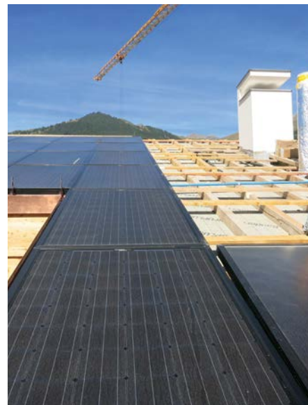
Bei der Überbauung Monolit in Scuol geht es um die Zukunft der Solarthermie. Ein erfolgversprechender Ansatz ist die Regeneration von Erdsonden mittels gespeicherter Solarwärme.
