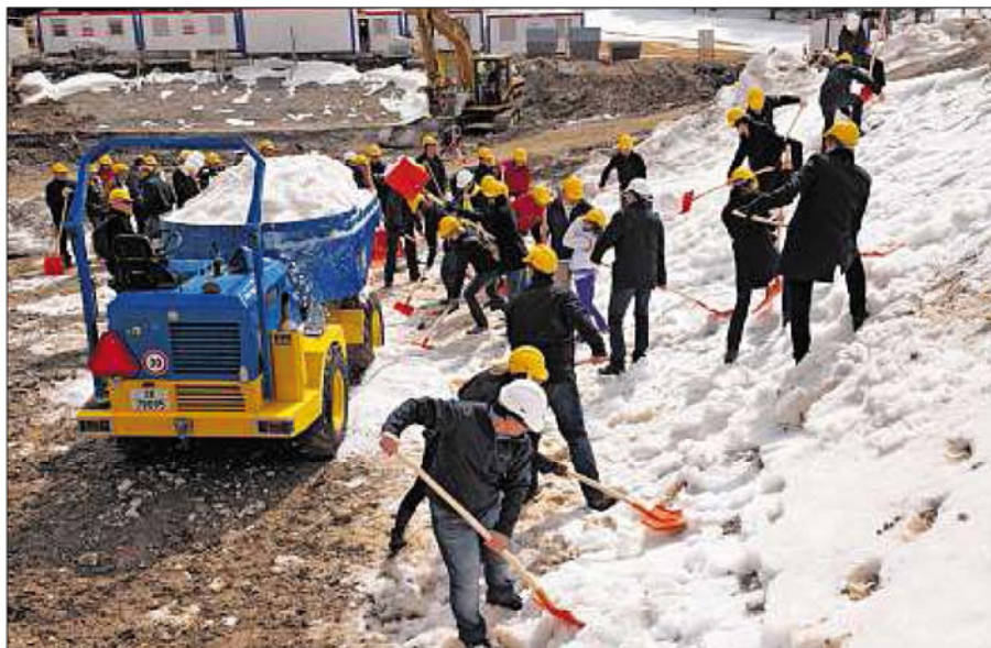
Schnee statt Erde: Der Spatenstich des neuen Sportzentrums und Hallenbad in St. Moritz verkam gestern zum Schneeschaukeln. (Foto Roll Canal)
