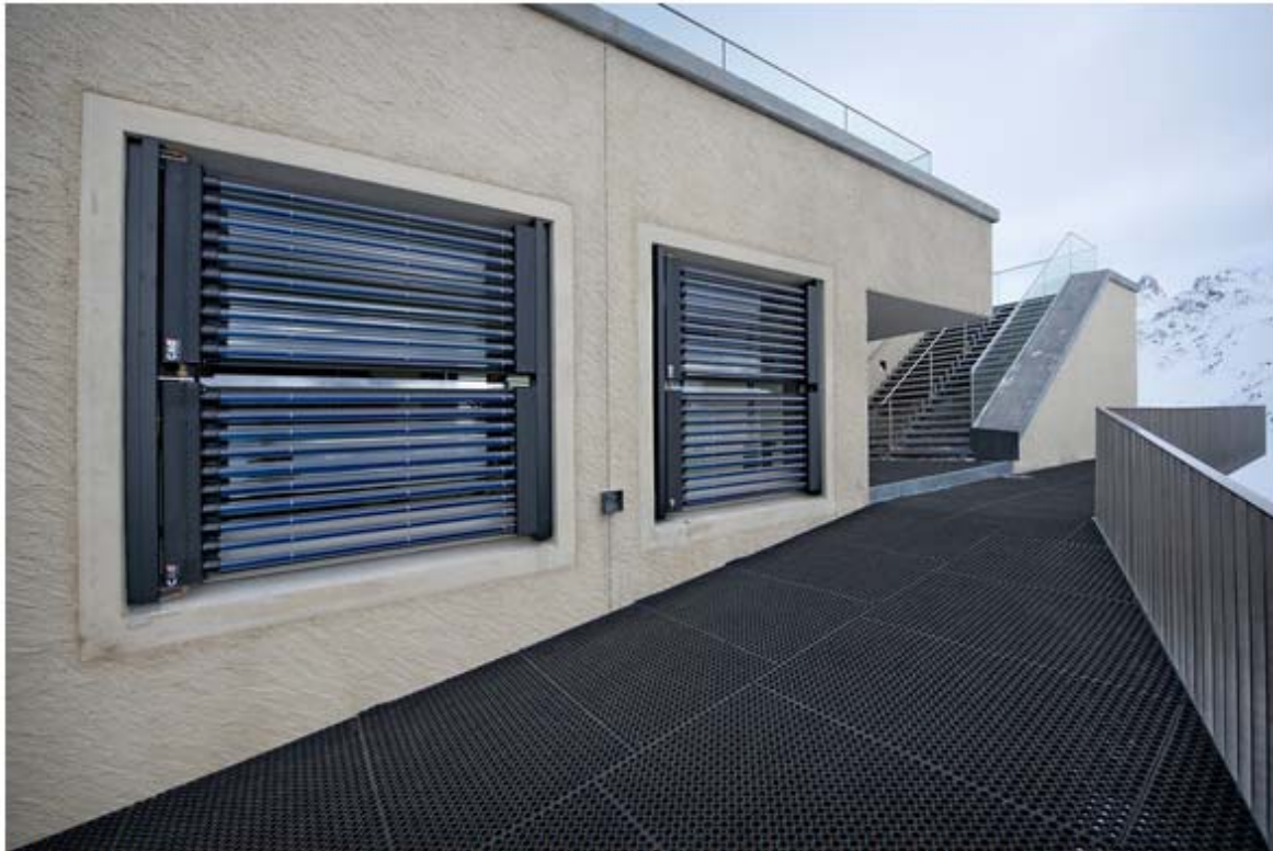
Die Röhrenkollektoren sammeln vor den Fenstern des Hotels Muottas Muragl Sonnenstrahlen ein.
