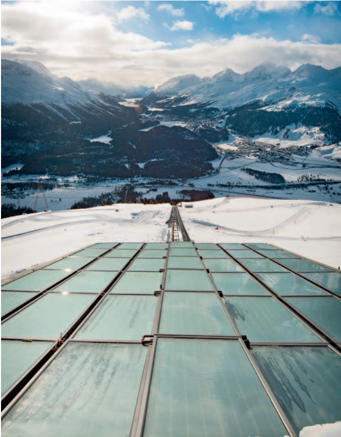
Flache Sonnenkollektoren auf dem Vordach der Bergstation. KMU-FOTOGRAFIE.CH
